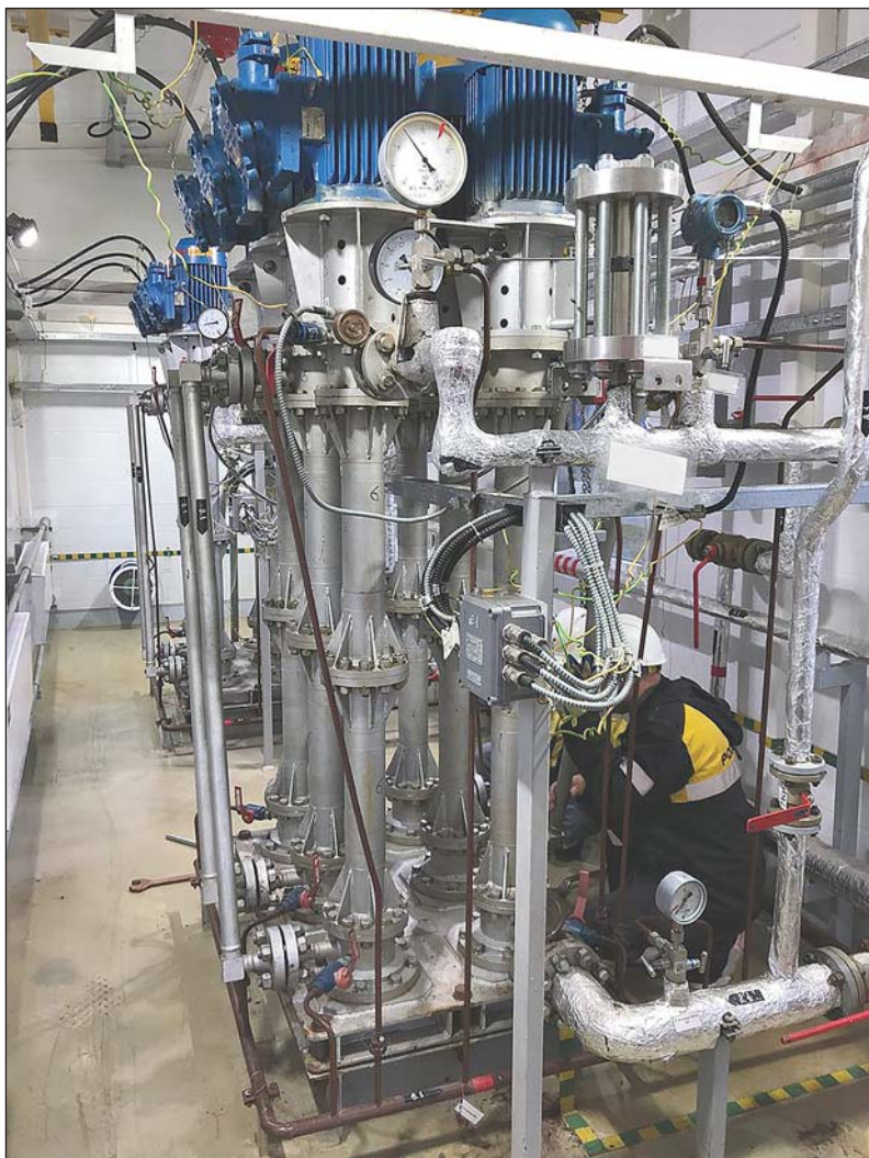
Рис. 1. Электронасосные агрегаты на объекте заказчика
