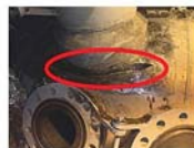
Вид дефекта типа трещина после разделки кромок
