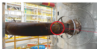
Фото участка технологического трубопровода с источником АЭ IV класса опасности – предаваружающее состояние
