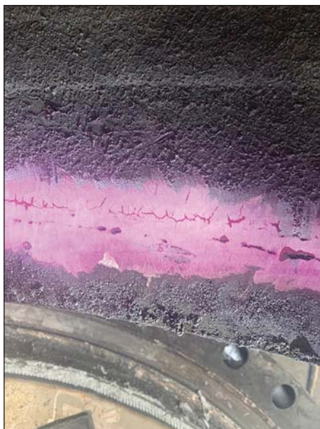
Рис. 5. Разрушение лакировки коксовой камеры
