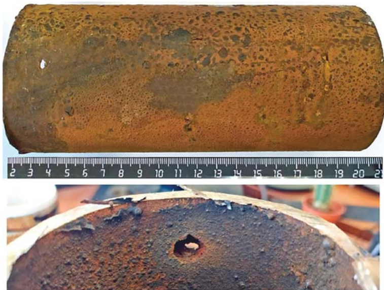
Рис. 1. Фото дефектного участка змеевика
